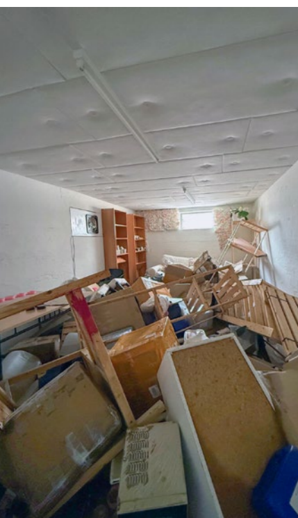
Wasserrohrbruch: Die Kraft des Wassers war so stark, dass Türen aufgewuchtet und Türrahmen aus der Mauer gerissen wurden. Unzählige private Gegenstände und Erinnerungsstücke wurden unbrauchbar.
