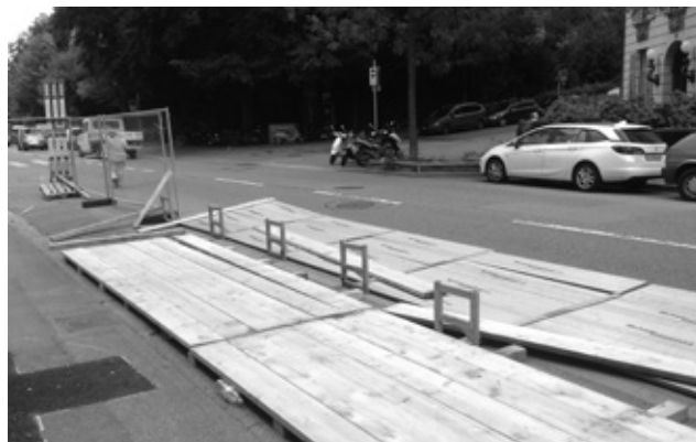
Umgestürzte Bauwand infolge Sturmböen. (Bild: Oliver Hörnlmann)
