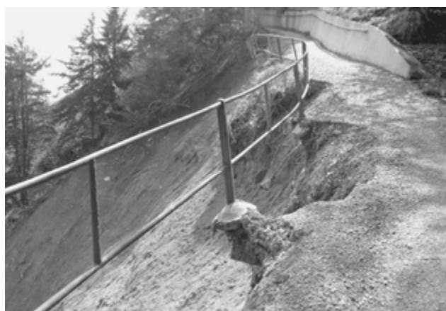
Abgerutschter Föhreneggweg am Uetliberg. (Bild: GSZ)
