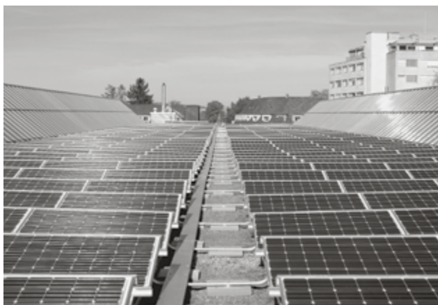
Fotovoltaikanlage auf dem Dach des Tramdepots Wollishofen. (Bild: VBZ)
