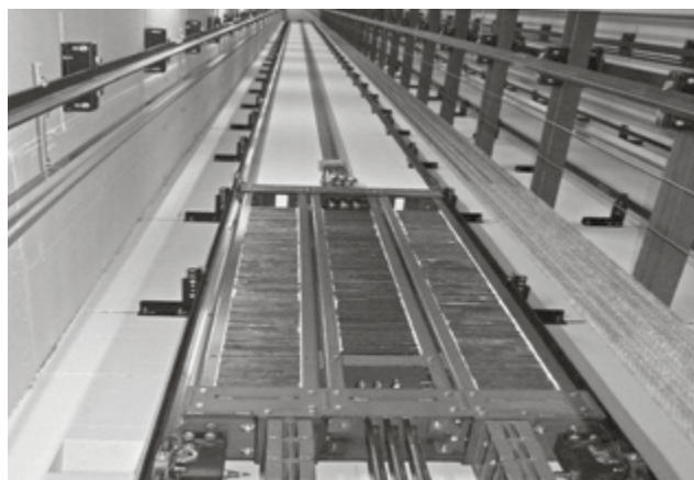
Aufzugskontrolle. (Bild: Ronny Oehme)
