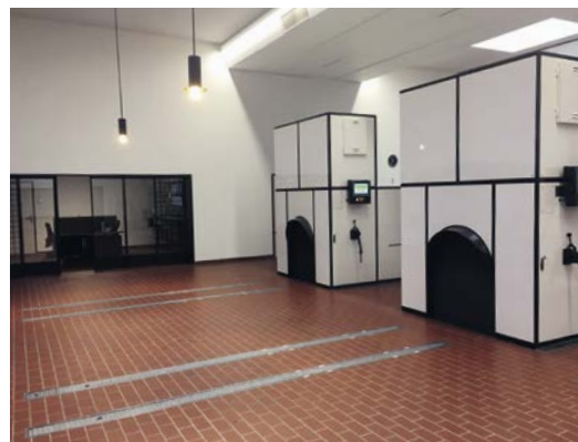
Ofenraum 1 im Krematorium Nordheim mit neuem Kommandoraum. (Bild: Stadt Zürich)
