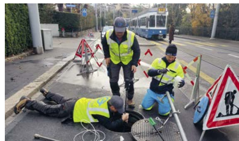
Limmattalstrasse: Einbau der Multiparametersonde im Mess-Schacht (Bild: WVZ)
