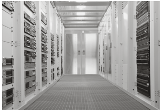
Innenansicht im Rechenzentrum Albis: Blick in einen Systemraum der städtischen Rechenzentren, die neu über eine Zertifizierung für effiziente Energienutzung verfügen. (Bild: Organisation und Informatik)
